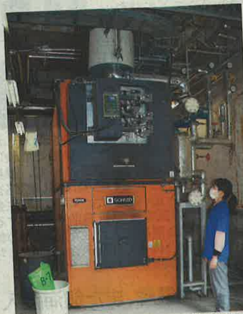
稼働して19年になる木質チップを燃料にするボイラー。和歌山県田辺市龍神村
